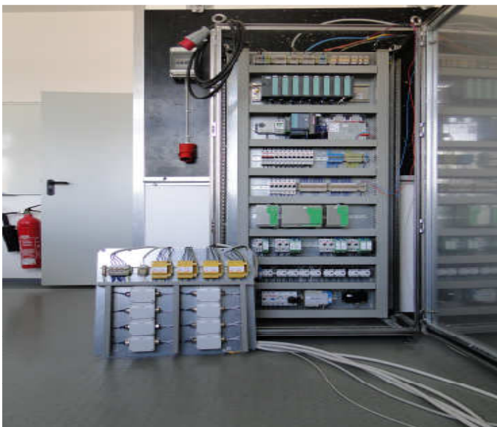
Abb. 8: DeMoS-Schrank mit der Baugruppe „Regelbausteine für acht LED-Anstrahler“, Testaufbau in der Werkstatt der Fachgruppe Nachrichtentechnik
